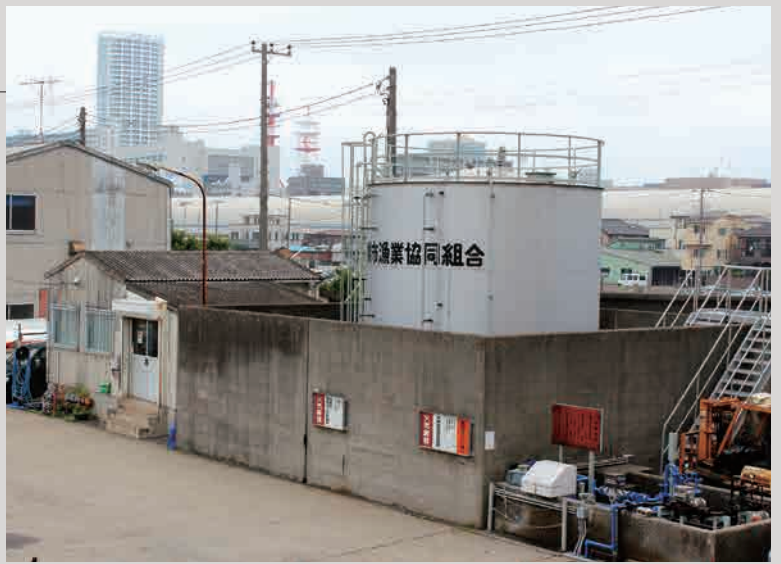
▲船橋油槽所の漁協向け備蓄タンク
